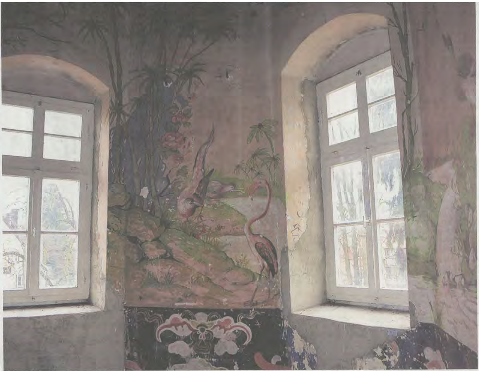
Das ehemalige Kinderzimmer im Meringer Schloss ist mit Wandmalereien verziert, die früher praktisch die Tapeten ersetzen. Nun wird das Schloss saniert und im Inneren verändert. Ein Investor will nach einer aufwendigen Kernsanierung 48 Wohneinheiten im historischen Gemäuer anbieten. Foto: Peter Stöbich
